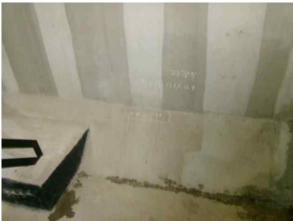
손상내용 유입밸브실 벽체 백태 손상원인 습윤침투
