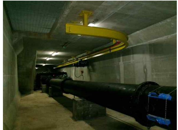
유출밸브실(지하2층) 내부 전경
