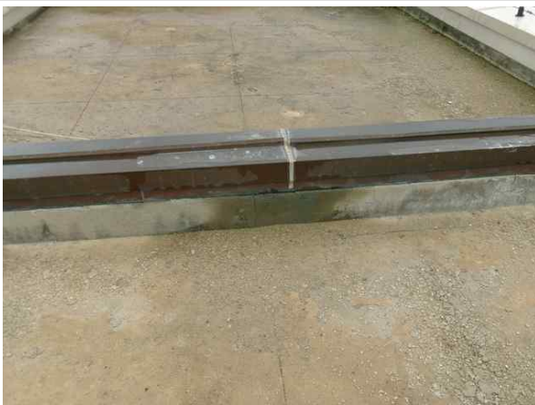
손상내용 검수실 옥상층 균열 손상원인 건조수축
