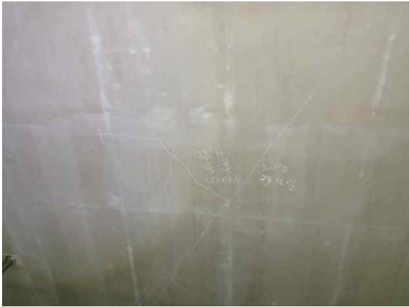
손상내용 유입밸브실 벽체 균열 손상원인 건조수축
