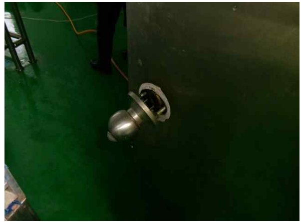
손상내용 검수실 내부도어 손잡이 파손 손상원인 외부 충격
