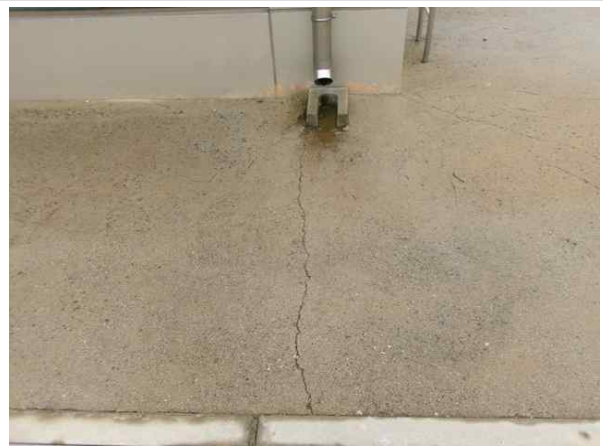
손상내용 검수실 외부바닥 균열 손상원인 건조수축
