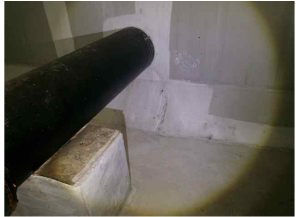
손상내용 유입밸브실 균열부 백태 손상원인 건조수축 + 습윤침투
