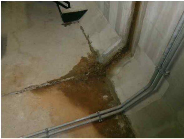
손상내용 유입밸브실 바닥슬래브 누수 손상원인 공용열화
