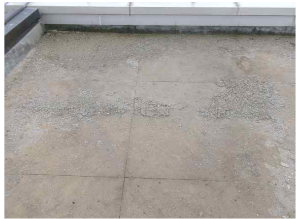
손상내용 검수실 옥상층 박리 손상원인 공용열화, 시공미흡
