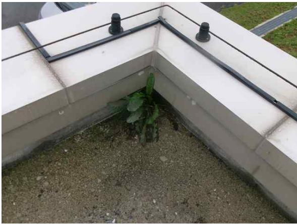
손상내용 검수실 옥상층 배수로 막힘 손상원인 이물질 퇴적
