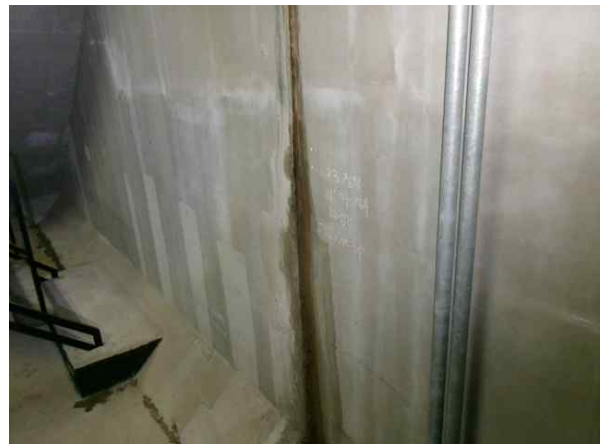
손상내용 유입밸브실 벽체 실란트 열화 및 누수 손상원인 외부 우수유입
