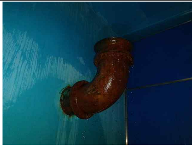
기계설비(2지 유입 배관)
