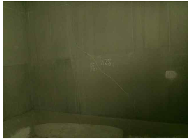
손상내용 유입밸브실 벽체 균열 손상원인 건조수축
