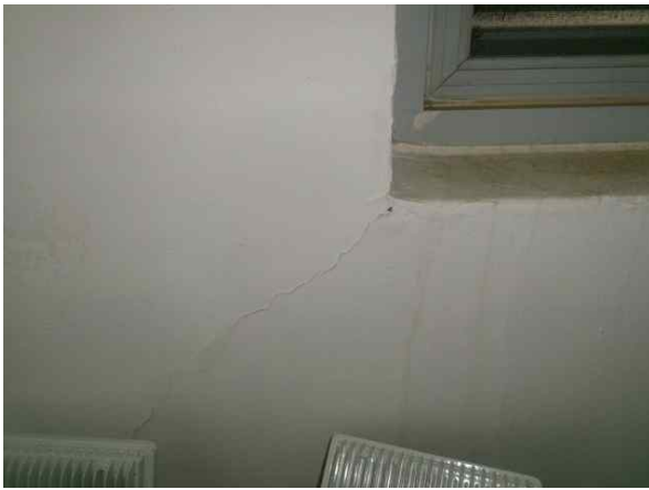
손상내용 검수실 벽체 균열 손상원인 건조수축
