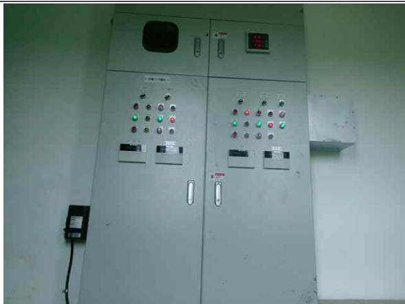
전기실 내부 전경
